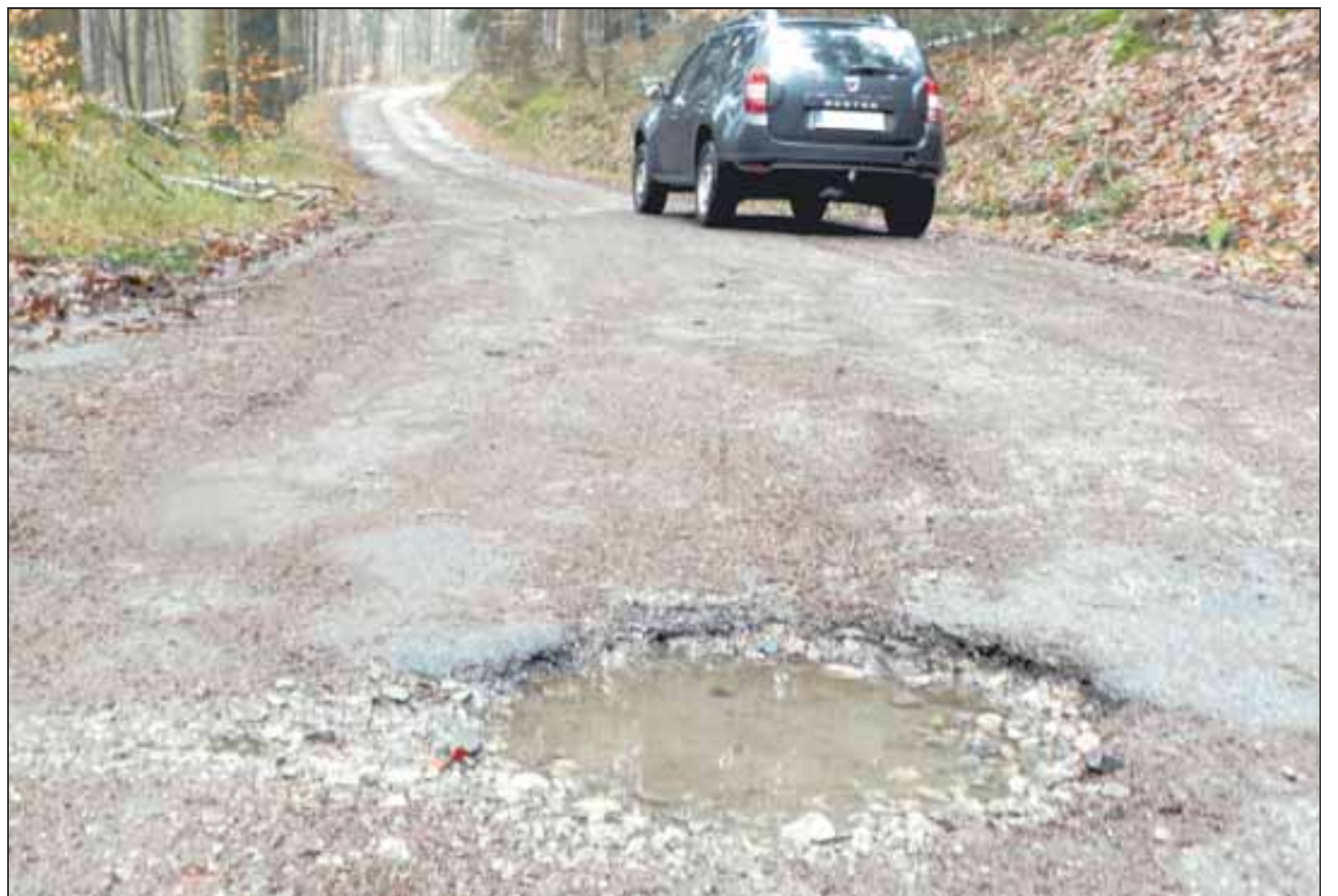
Der Gemeindeverbindungsweg zwischen Brombach und Heddesbach ist mit Schlaglöchern übersät. Fotos: Deschner
